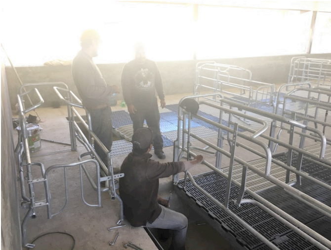
Cama para cerdas en maternidad colocada sobre fosa para drenaje.
