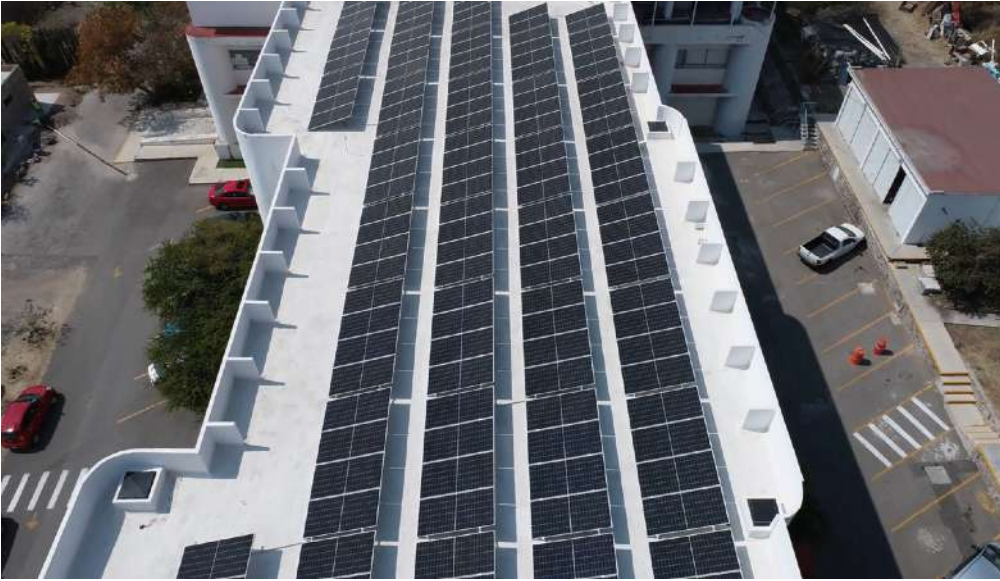
Figura 24. Páneles solares colocados de campus Juriquilla.
