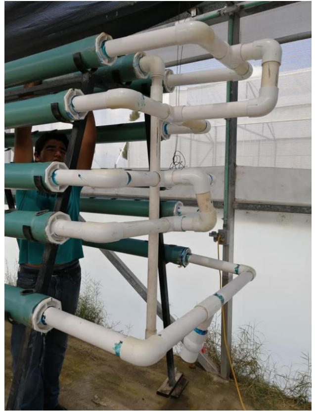
Fig. 6 En la figura se puede apreciar el filtro para aguas residuales proporcionado por el Laboratorio de Bioingeniería, con sus respectivas conexiones y llaves de paso.
