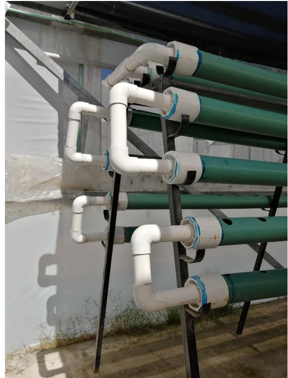
Fig. 9 En la figura se puede apreciar la parte posterior del sistema de acuaponía en forma piramidal, con sus tubos y conexiones de PVC respectivamente.
